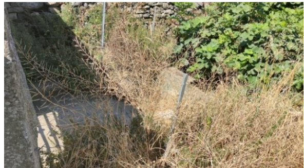
Foto 3 - Sbocco canale di raccolta acque meteoriche
