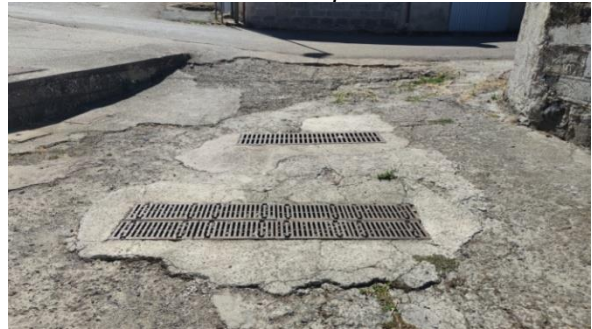
Foto 2 - Griglie di raccolta delle acque di scorrimento superficiale
